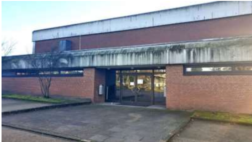
Abbildung 17: Die Sporthalle Am Timmerahde. Neben den nutzerseitigen Rückmeldungen zum Boden und der Tribünnennutzung wird eine energetische Sanierung empfohlen.
