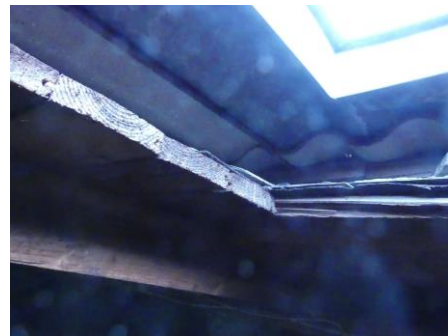
Abb.15: Spaltraum im Dach
